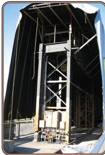
La vanne en acier du barrage de Chesterville.
